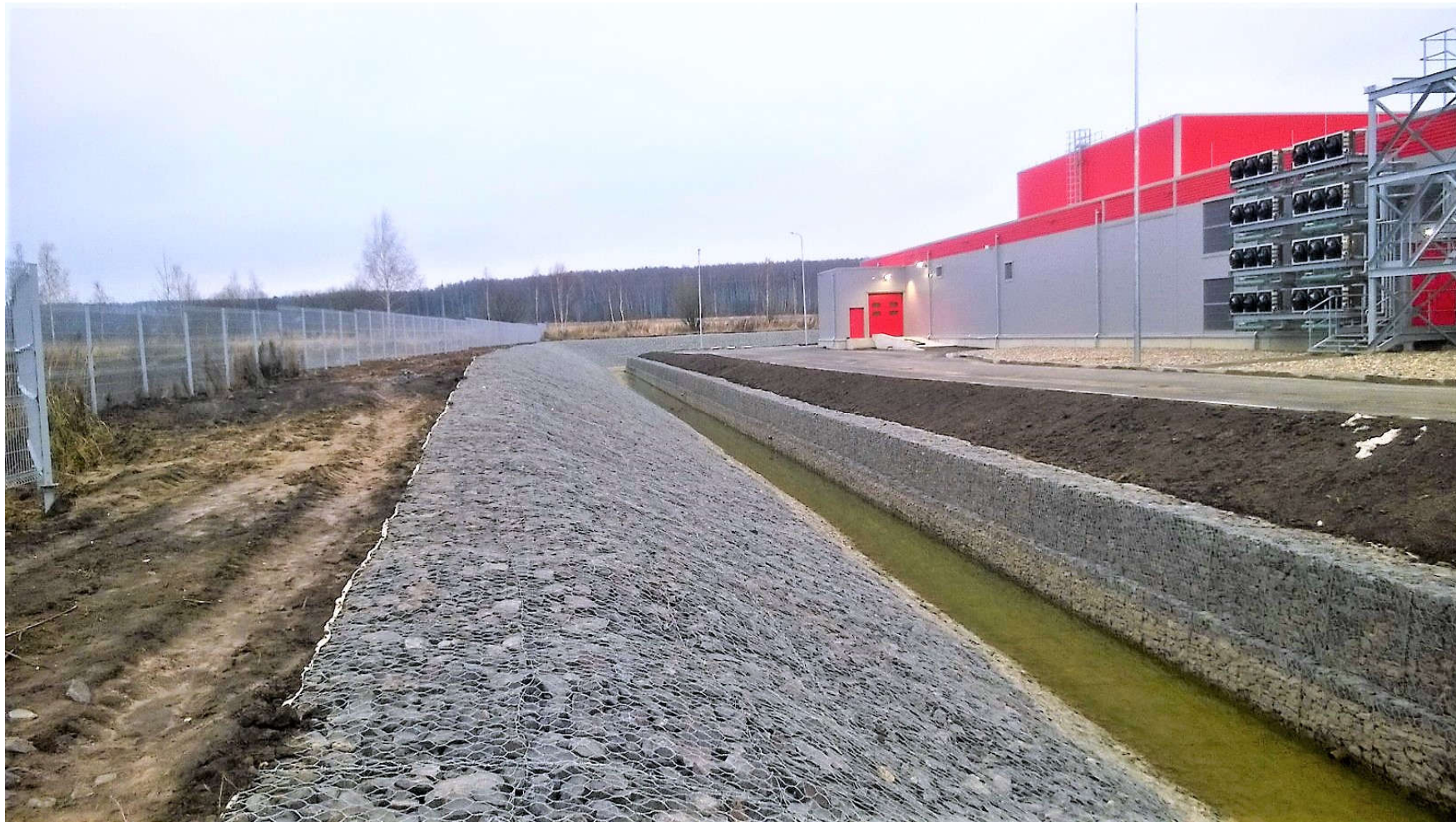
ЯНДЕКС. Центр обработки данных. Водоотводные сооружения. Владимир
